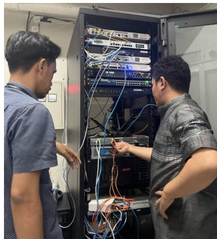
Gambar 1. Survey kondisi Infrastruktur Server UNM
